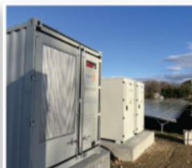
所在地: 香川県 蓄電池容量: 442kWh 用途: 再エネアグリゲーション 稼働時期: 2024.3
