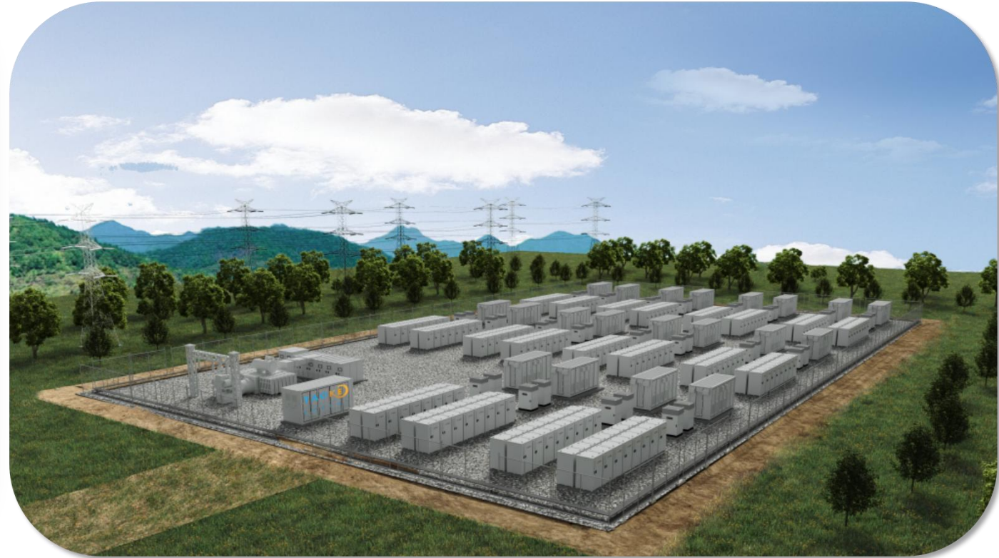
50MW/130MWh特別高圧系統用蓄電池システム
