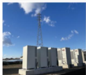
所在地: 香川県 蓄電池容量: 663kWh 用途: 再エネアグリゲーション 稼働時期: 2024.3
