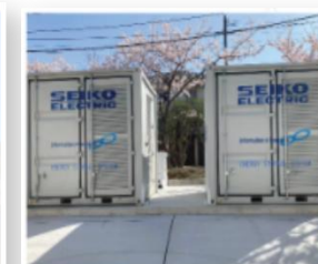
所在地: 福岡県 蓄電池容量: 215kWh*2 用途: ODM開発 稼働時期: 2021.10
