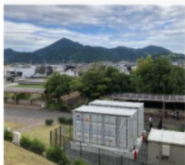
所在地: 熊本県 蓄電池容量: 2580kWh 用途: ピークカット+BCP 稼働時期: 2022.7
