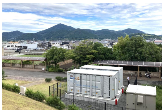
※TAOKE ENERGY の熊本県の納入現場
